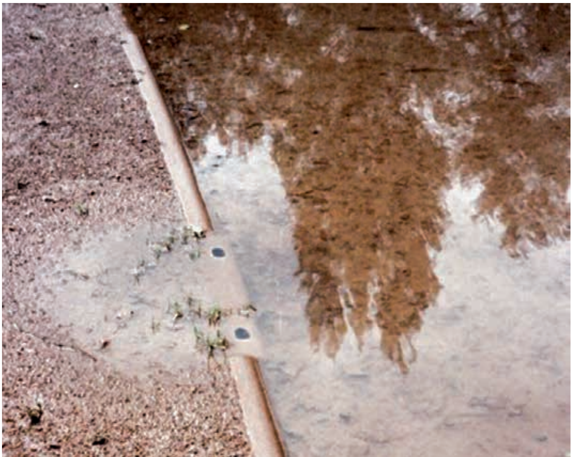
Abb. 85: Einlaufkasten steht unter Wasser, funktionsunfähig
