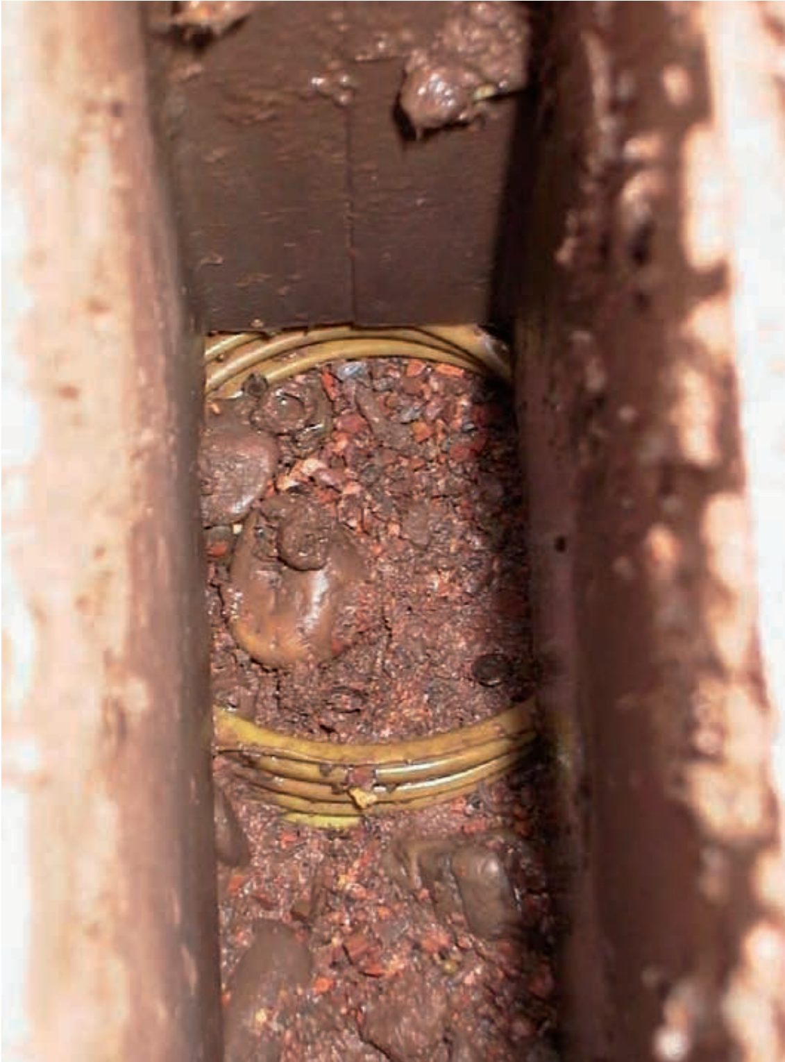
Abb. 86: Einlaufkasten mit verstopftem Dränrohr
