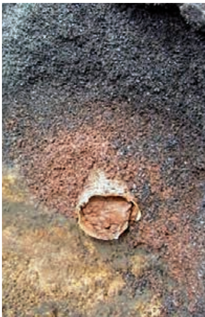
Abb. 91: Verstopftes Dränrohr mit verunreinigter Dränpackung
