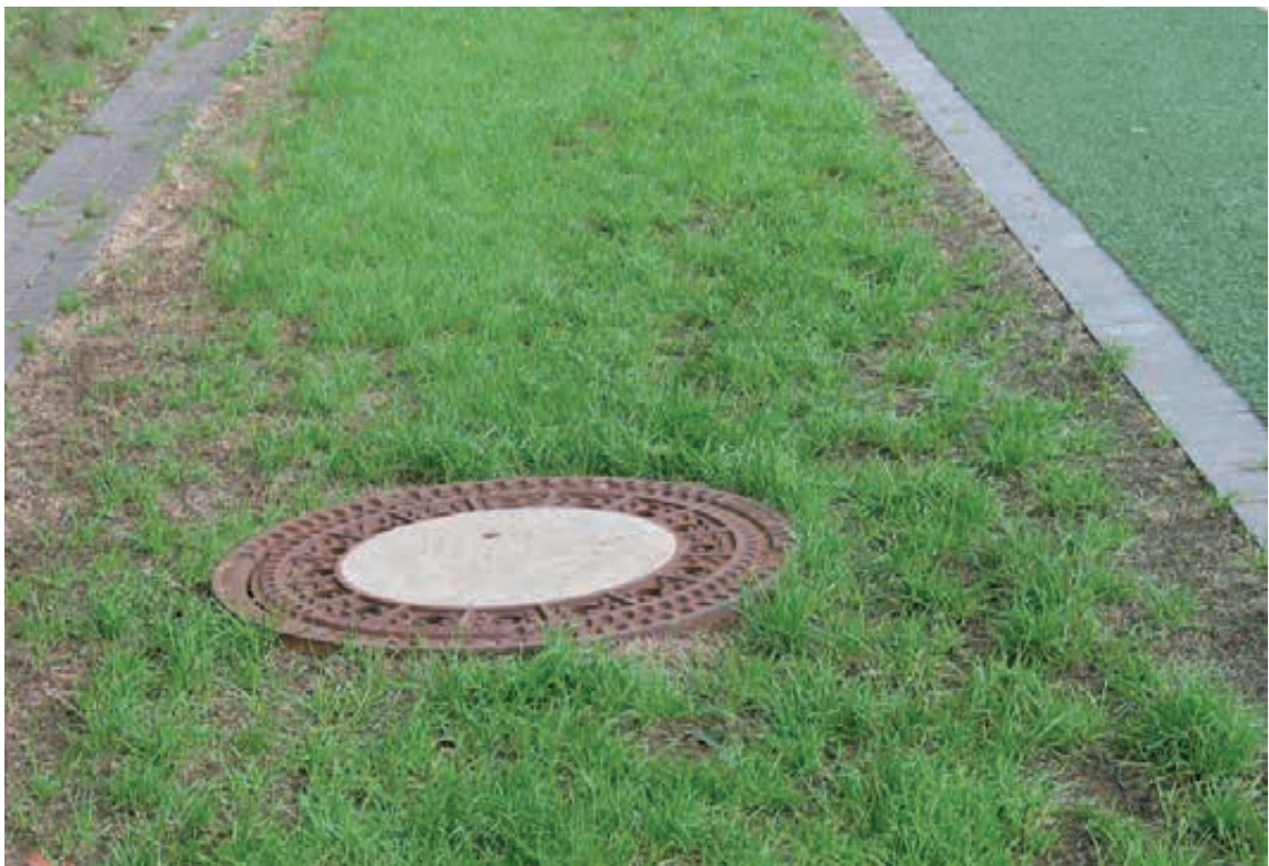
Abb. 11: Schachtdeckel innerhalb des hindernisfreien Raumes
