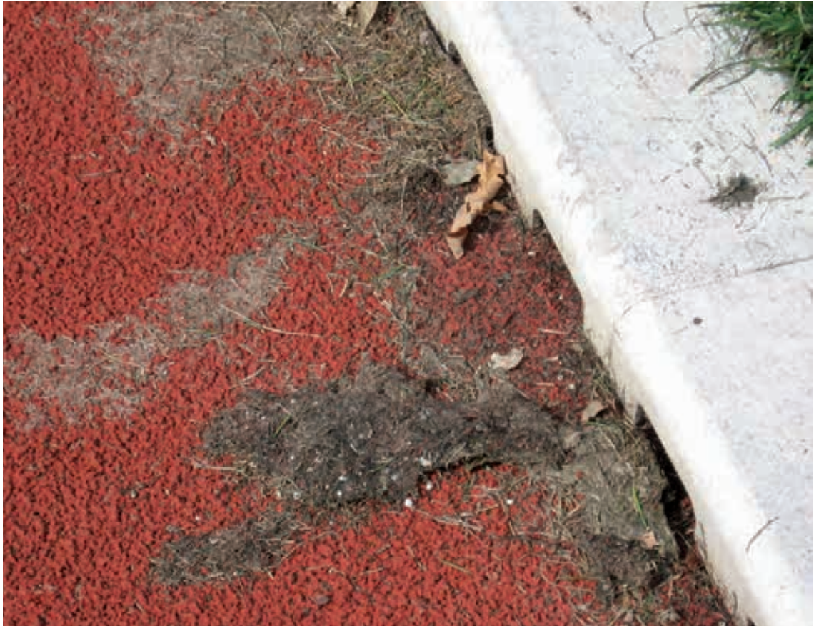
Abb. 109: Wasserabfluss durch Mähgut eingeschränkt
